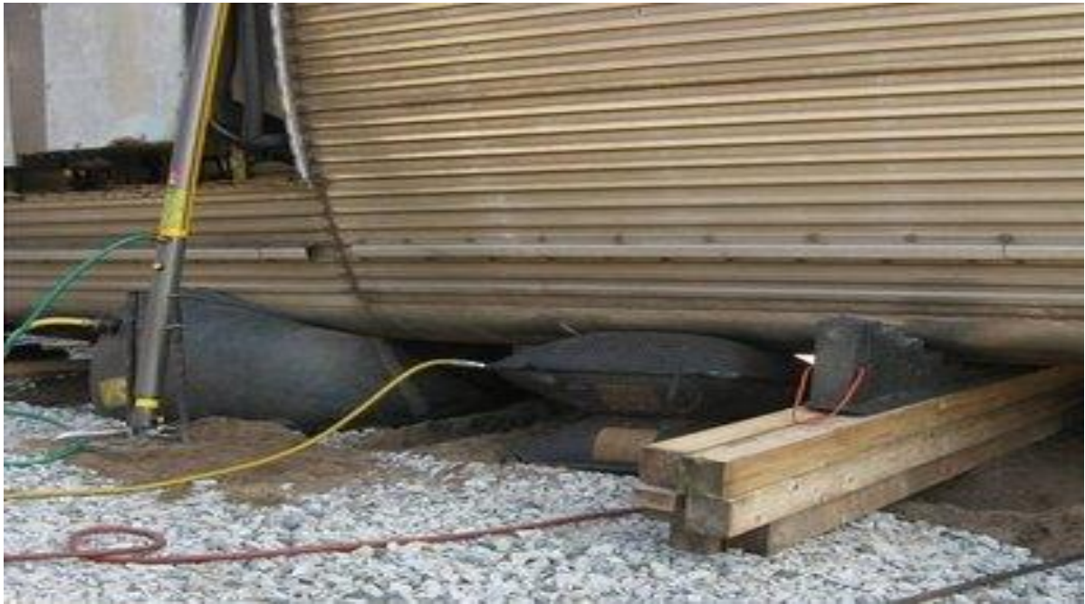
Figur 15. Stötta kan fästas mot längsgående balk på taket och förankras med platta i marken enligt bilder på övre raden. Man kan också använda pallvirke och Cribbingblock om det finns utrymme att få in dem under vagnen (undre bilden).
